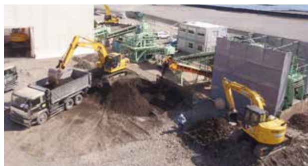
カルスピン工法プラント全景
